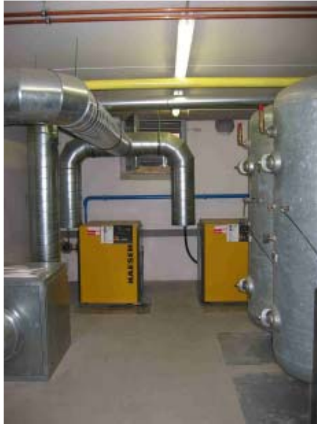
Abb. 21: Druckluftstation mit Wärmeabführung
