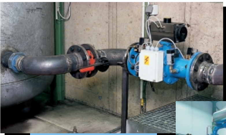
Der Bypass zur Druckhaltung des Kessels an Wochenenden
