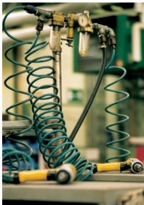
Abb. 3: Energie-„Vernichter“ im Druckluftnetz
