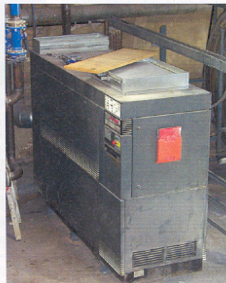
3: Kompressoraufstellung ohne Anbindung an Zu- und Abluftkanäle
